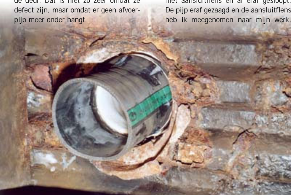
Wat is dit? Een vogelnestje? Een defecte uitlaat van een vrachtwagen? Nee, de wc-pijp van de 766. (Foto: Ruud van Schaik )
